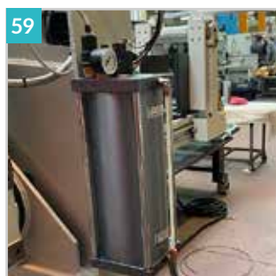
59 000947 Sistema lubrificação mínima 3 litros
